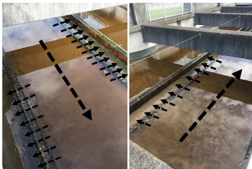
写真1 最終沈殿池の汚泥流出状況（左：上流側 右：下流側 矢印：水の流れ）
